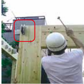
施工時に出してしまう金物の出っ張り
