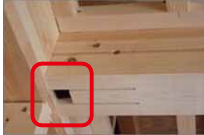
組み付け部分に隙間が生じている
