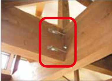
金物が露出している
